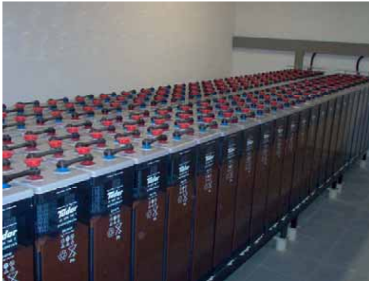
Acumuladores de la Planta Fotovoltaica de la UA (CTQ)
